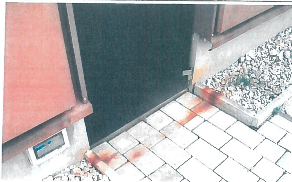
Obr. 3 Ušpinění okolních konstrukcí od stékající kontaminované vody
