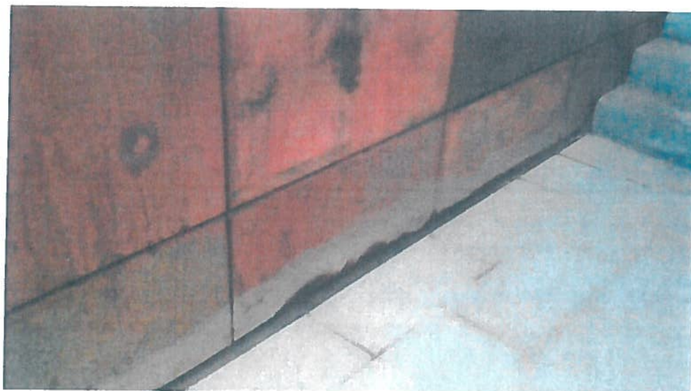
Obr. 4 Nevhodná instalace s dlouhodobým ovlhčením materiálu a zjevná odlišná patinace
